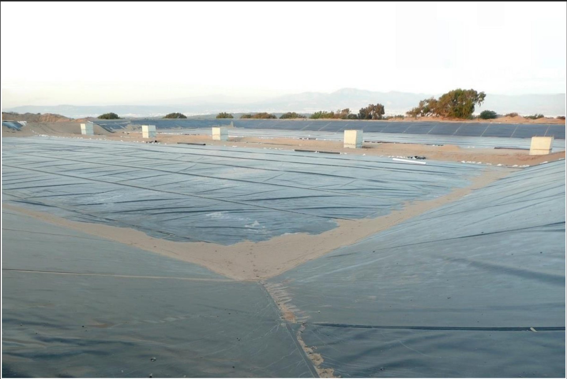
Čistírna odpadních vod M'ZAR, MAROKO Filtrační nádrže, JUNIFOL PEHD 1,5 G/G (298 000 m 2 )
